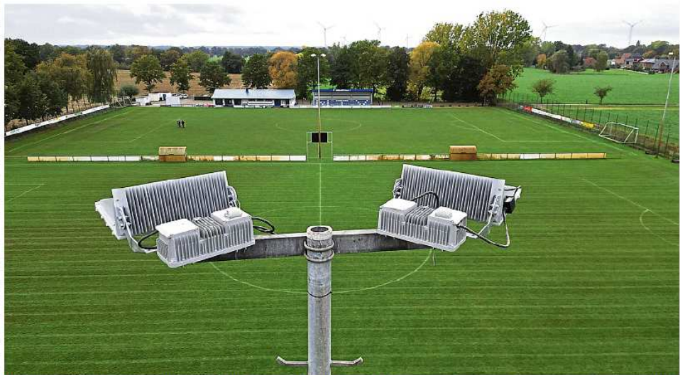
Die alten Halogen-Lampen rings um einen der beiden Fußballplätze des MTV Riede auf der Sportanlage am Segelhorst sind nun durch eine moderne, energieeffiziente und weniger wartungsintensive LED-Beleuchtung ausgetauscht worden. WALTER (2)
